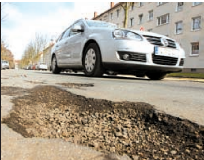
400.000 Euro werden allein zum „Löcherflicken“ benötigt.
