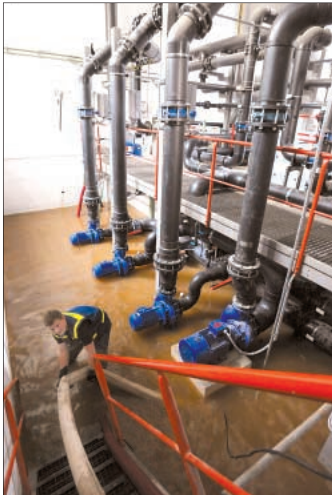
Badtechnik unter Wasser. Die Feuerwehr pumpte die braune Brühe aus dem Gebäude. Nun stehen Reparaturen an. Foto: Seidel
