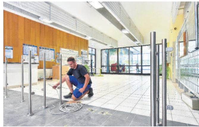
In der Schwimmhalle »Am Südring« wird derzeit das defekte Kassensystem durch ein neues ersetzt. Foto: Wolfgang Schmidt
