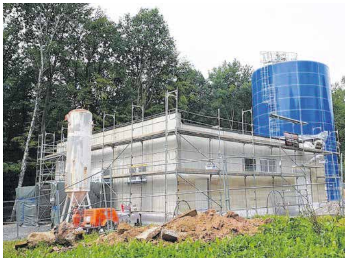
Um die Kühlung der Krankenhäuser so energiesparend wie möglich zu gestalten, erweitert die eins energie in Sachsen GmbH & Co. KG in Kooperation mit der Kliniken Chemnitz gGmbH und der Technischen Universität Chemnitz derzeit die Kälteversorgungsanlage des Klinikums. Foto: Stadt Chemnitz
