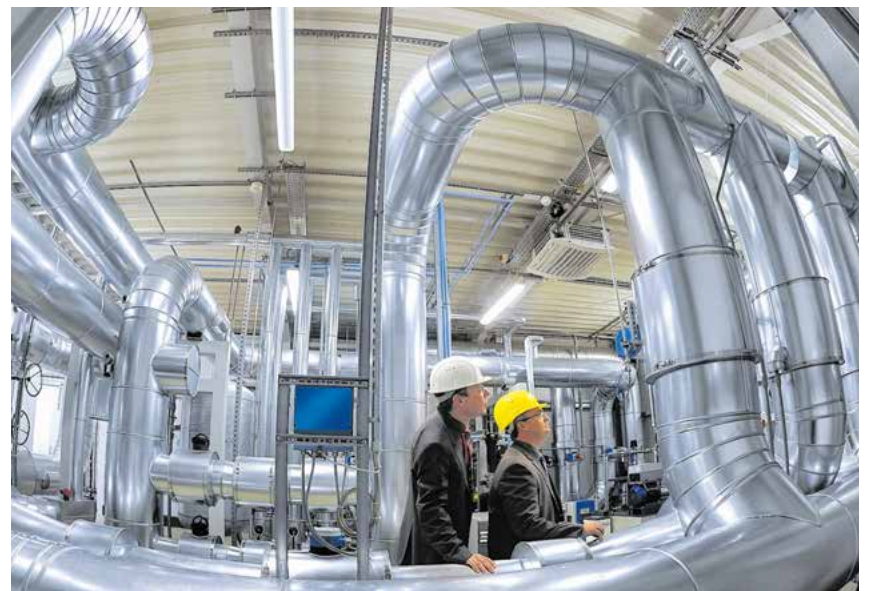
Prof. Thorsten Urbaneck von der Professur Technische Thermodynamik an der TU Chemnitz und Ulf Uhlig (re.) von »inetz« arbeiten an innovativen Energiekonzepten. Hier befinden sich beide in der Steuerzentrale des Großkältespeichers Chemnitz. Archivfoto: Wolfgang Thieme
