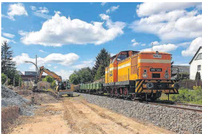
Der VMS startete den größten Neubauteil für die Bahnstrecke Chemnitz - Aue zwischen Chemnitz-Reichenhain und Chemnitz-Süd. Foto: VMS
