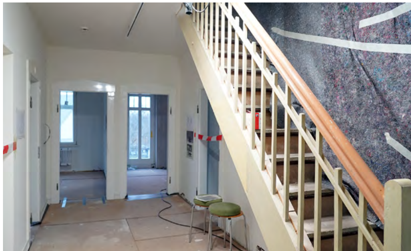
Blick in das erste Oberschoss, in dem sich Ausstellungsräume befinden werden. Dieses erreicht man auch barrierefrei über einen Fahrstuhl (links am Bildrand zu sehen).
