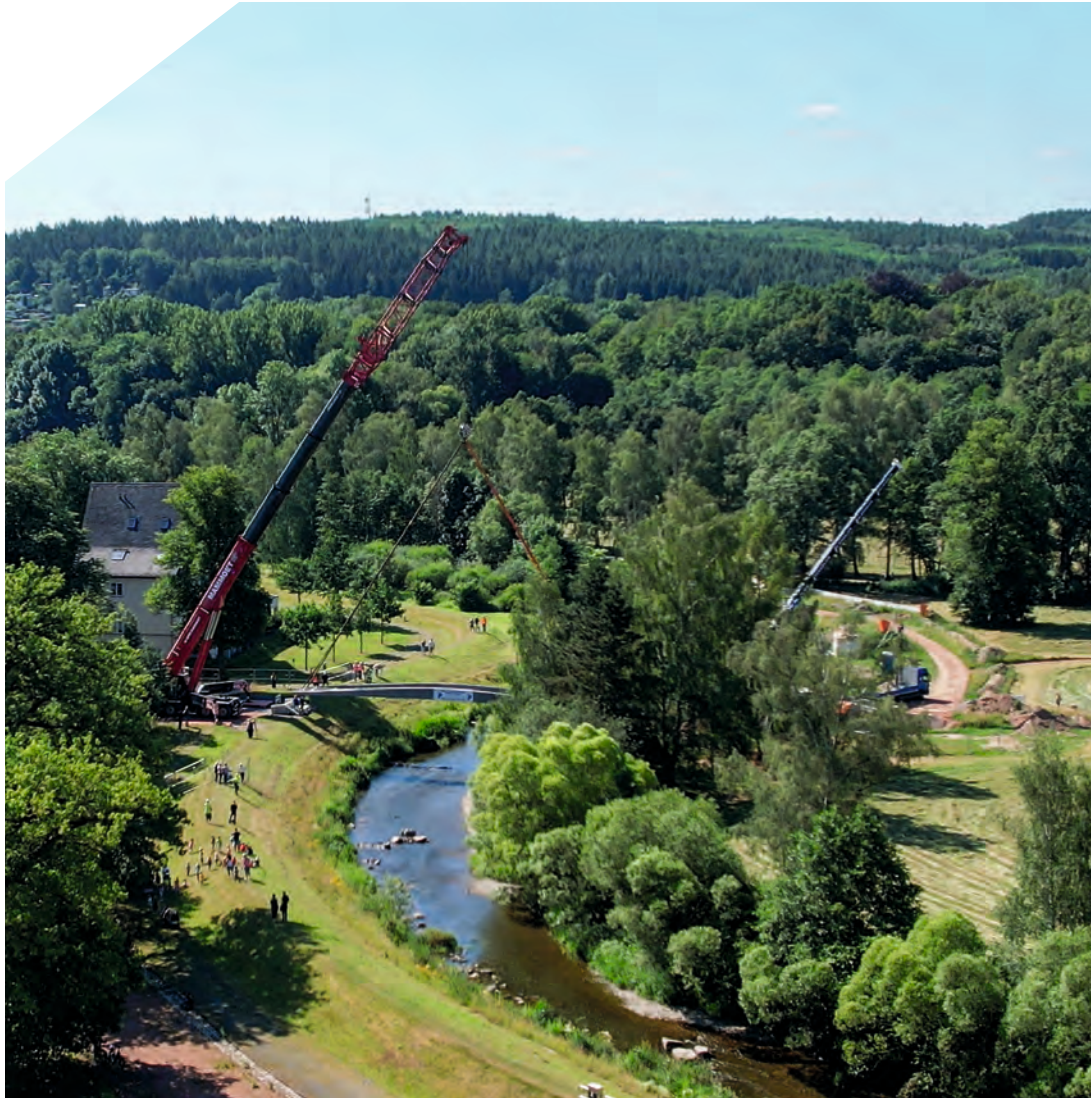
Im Juni 2024 hob ein Kran die Segmente der Fußgängerbrücke im ehemaligen Flussbad Altchemnitz ein. In June 2024, a crane lifted the segments of the pedestrian bridge at the former Flussbad Altchemnitz into place.
