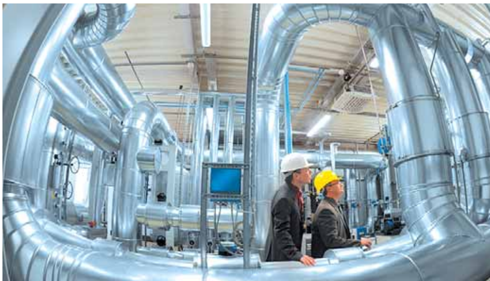
Dr. Thorsten Urbaneck (l.), Bereichsleiter Thermische Energiespeicher an der Professur Technische Thermodynamik, ist gemeinsam mit Ulf Uhlig von der energie in sachsen oft in der Steuerzentrale des Großkältespeichers Chemnitz anzutreffen. Foto: Wolfgang Thieme/TU
