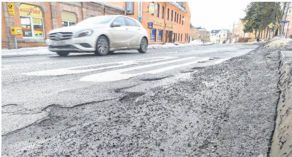
Die Frankenberger Straße zwischen Ebersdorfer Höhe und Ortsdurchfahrt hat zahlreiche Schäden, Risse und Unebenheiten. Das Teilstück soll nun saniert werden. Foto: Andreas Seidel
