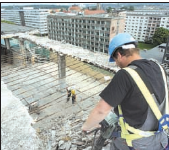
Das 300 Quadratmeter große Dach, das den Abschluss der gekrümmten Vorderfront des früheren Kaufhauses Schocken bildet, ist marode und muss abgerissen werden.
