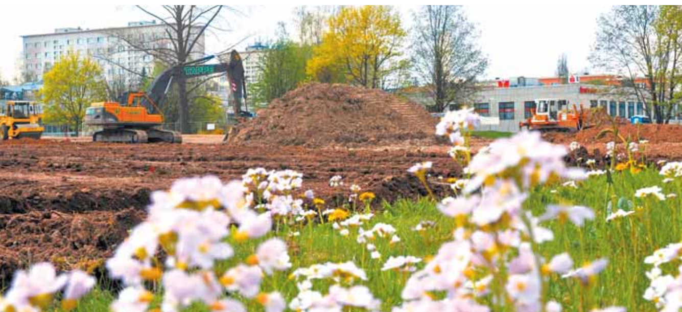
Eine Schulruine weicht jetzt frischem Grün. Das frühere Schul-Gelände will die Stadt einer attraktiven Nutzung zuführen.
