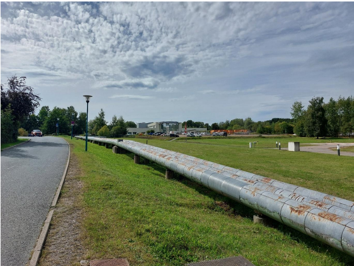
Abbildung 10: Südliche Fernwärmeleitung (Quelle: eigene Darstellung)
