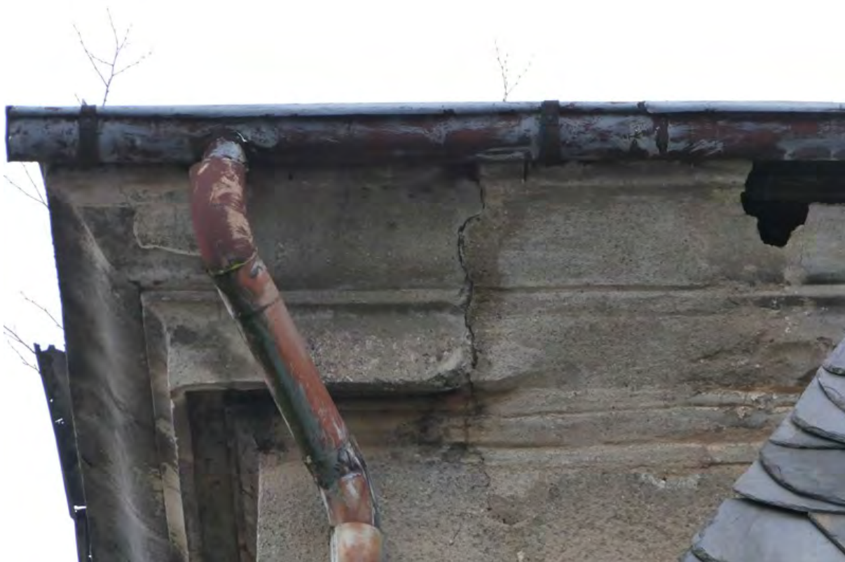
Foto 28: Hauptgebäude, Mauerrisse und Löcher in der Fassade als potenzielle Quartiere für Vögel und Fledermäuse, 02.12.2024.
