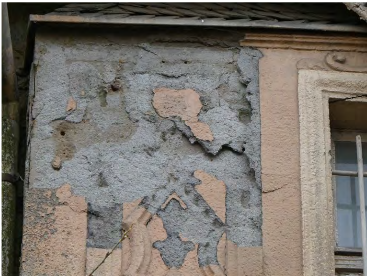
Foto 26: Fassade Hauptgebäude, Putzschollen als potenzielles Fledermaus-Quartier (exemplarisch), 02.12.2024.
