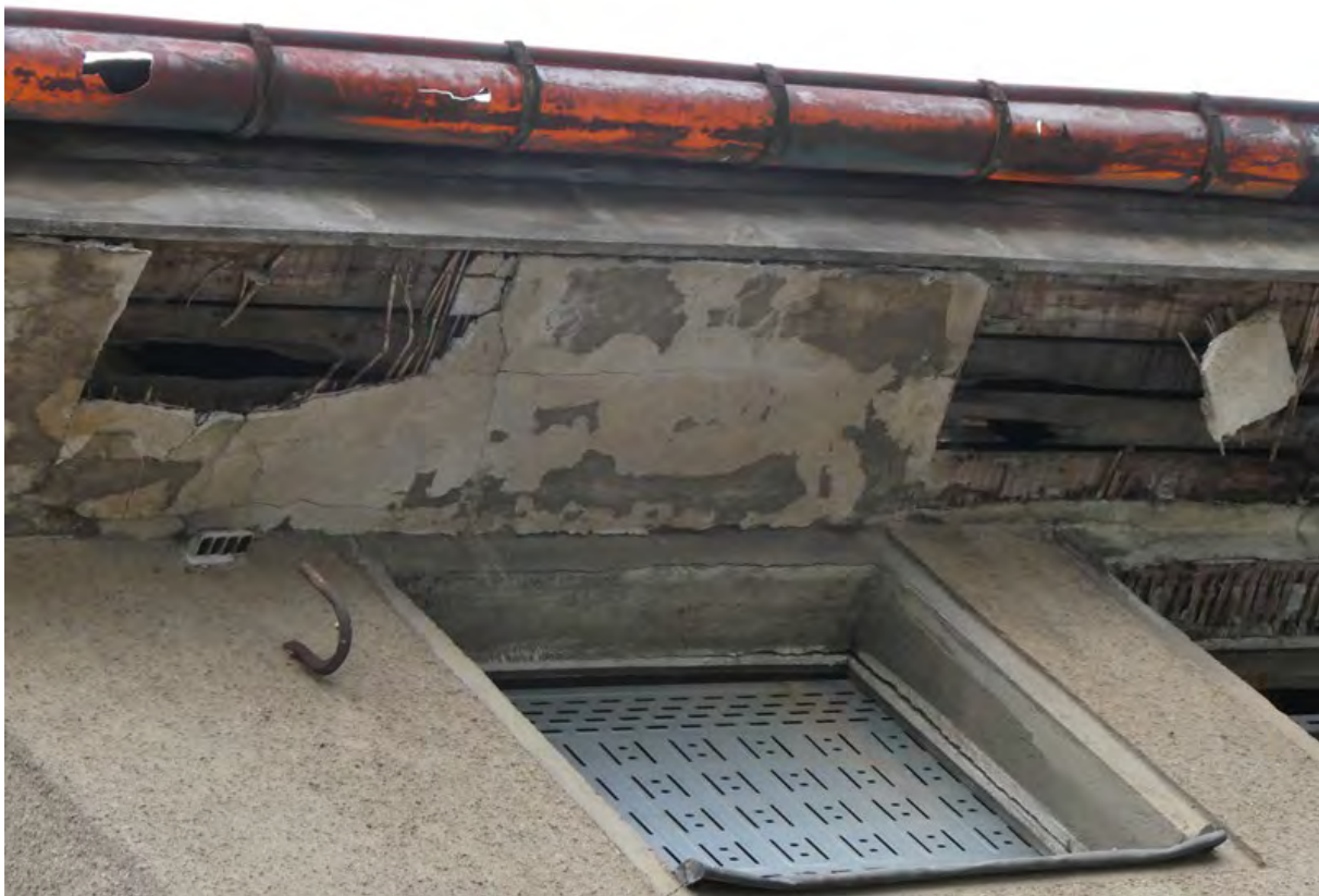
Foto 22: Defekter Dachkasten (exemplarisch) als potenzielles Quartier für Vögel/Flm., 02.12.2024.
