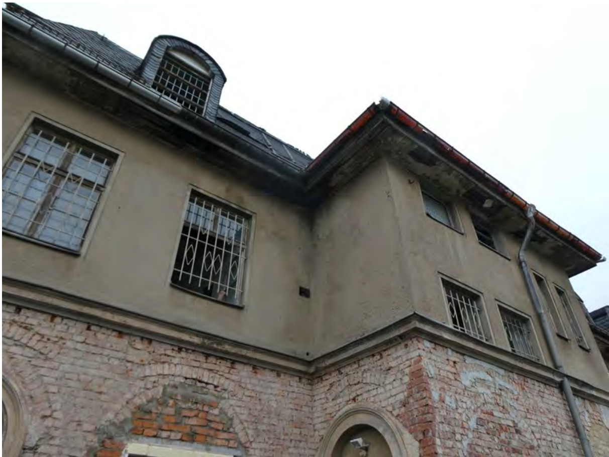
Foto 21: Blick vom Innenhof auf das Hauptgebäude mit maroden Dachkästen, 02.12.2024.
