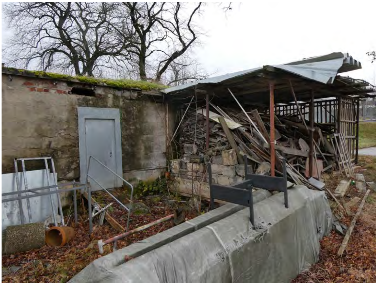
Foto 13: Innenhof des Geltungsbereichs mit Garage und vermülltem Anbau, 02.12.2024.
