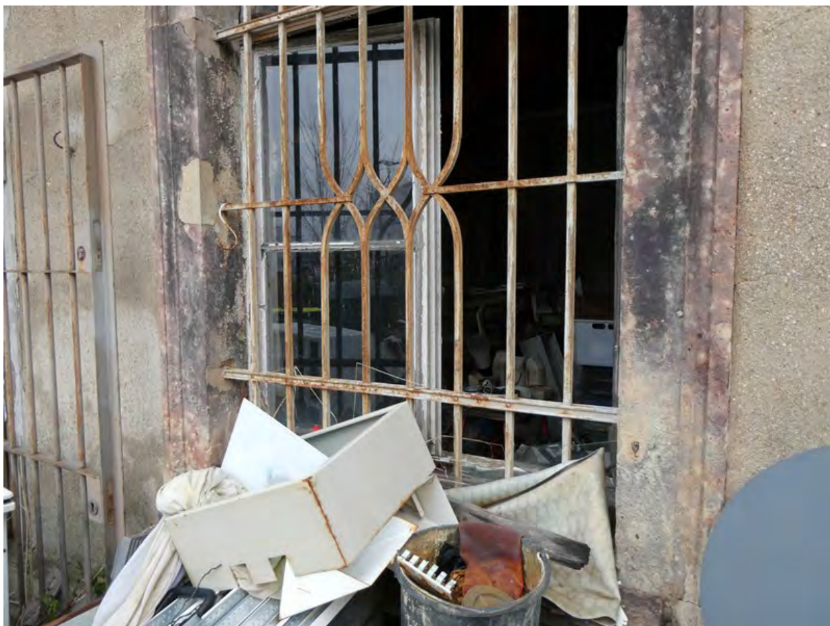
Foto 18: Anbau Hauptgebäude, stark vermüllte Innenräume, 02.12.2024.
