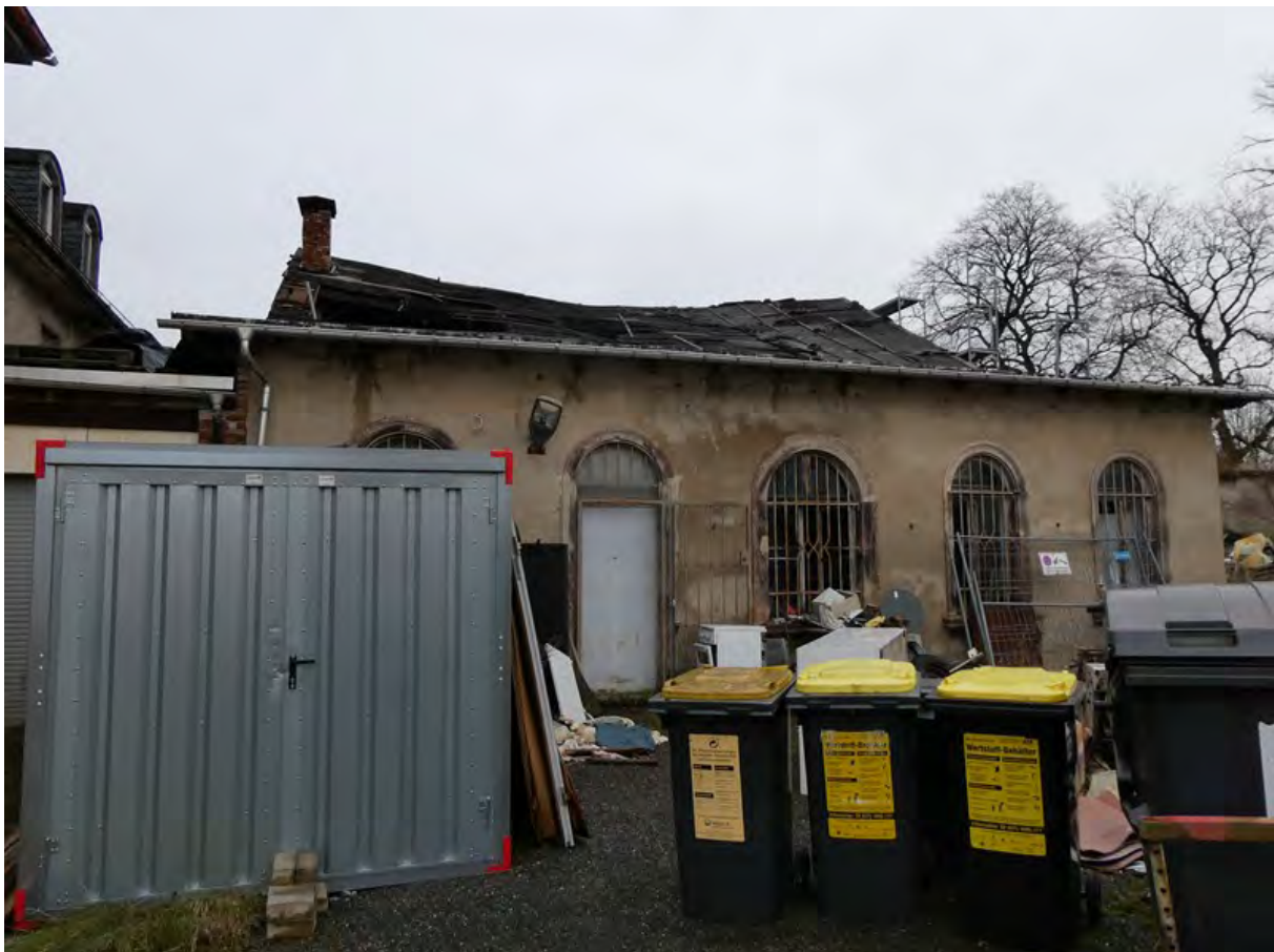
Foto 20: Blick von West auf den maroden Anbau mit eingestürztem Dach, 02.12.2024.
