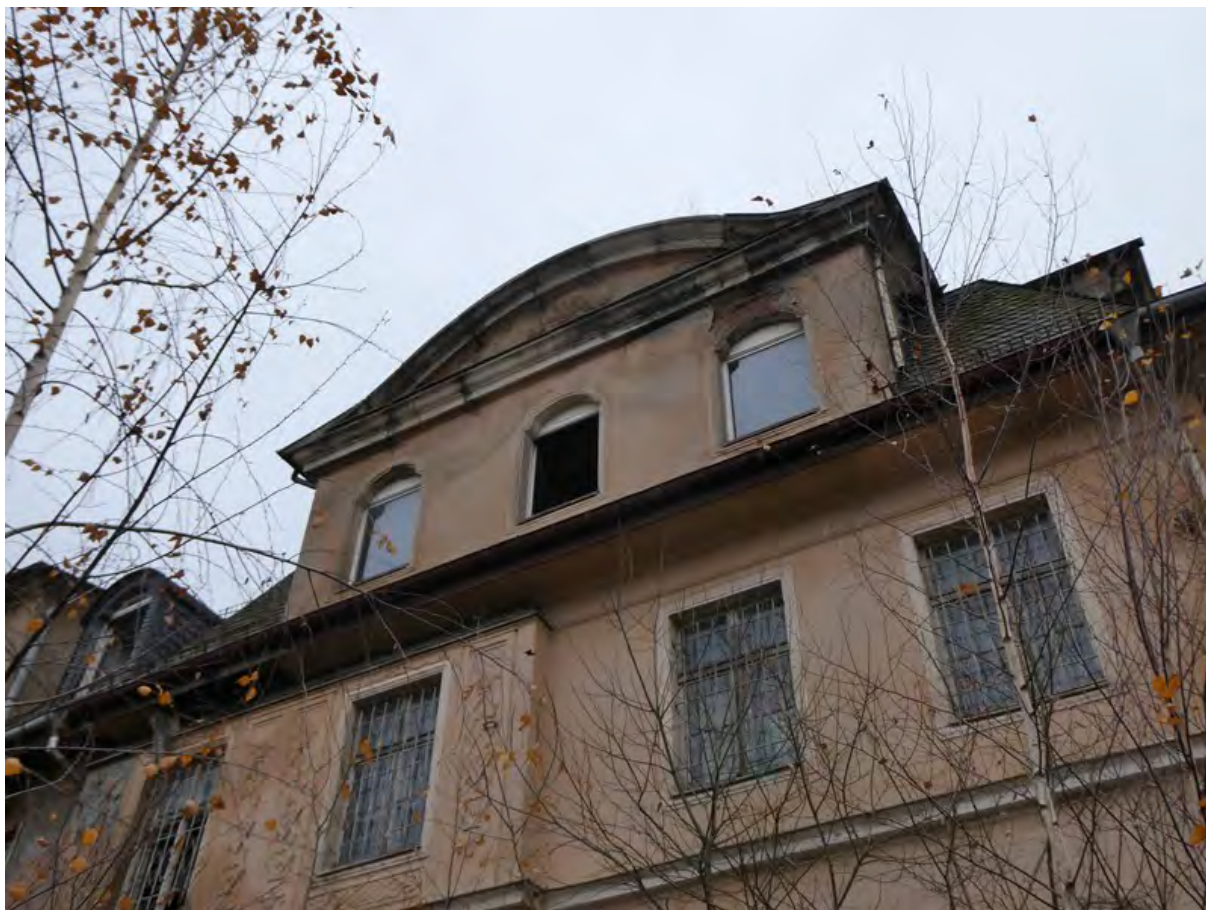
Foto 25: Offen stehende Fenster als Einflugmöglichkeit für Vögel und Fledermäuse, 02.12.2024.
