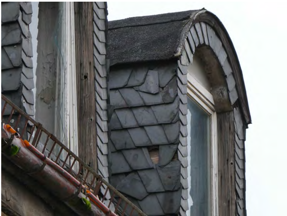
Foto 23: Gaube mit pot. Fledermaus-Quartieren im Bereich von losen Dachschindeln, 02.12.2024.
