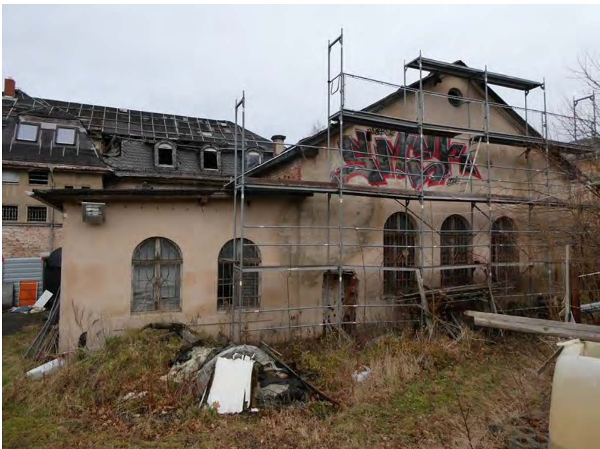
Foto 16: Blick von Süd auf den maroden Anbau des Hauptgebäudes, 02.12.2024.
