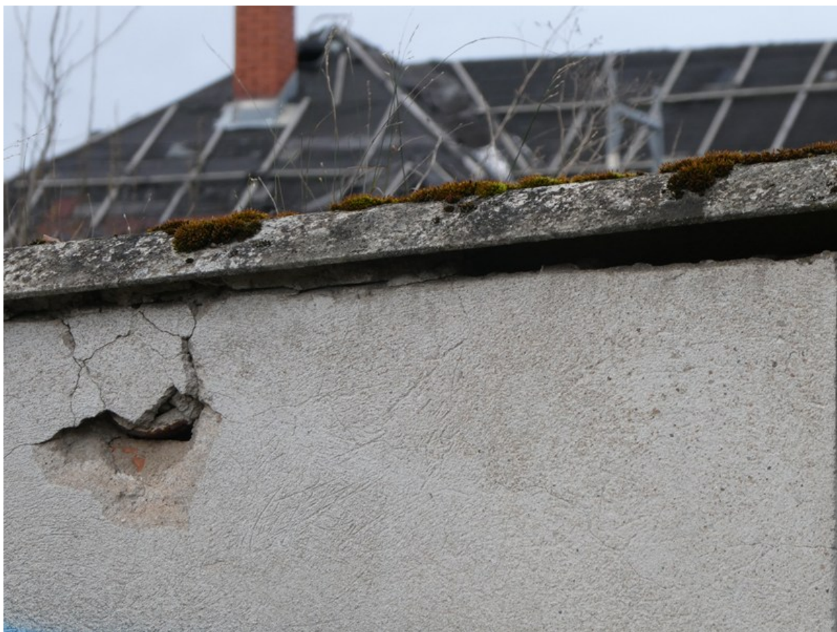
Foto 12: Fehlstellen als potenzielle Quartiere am Garagenkomplex (exemplarisch), 02.12.2024.
