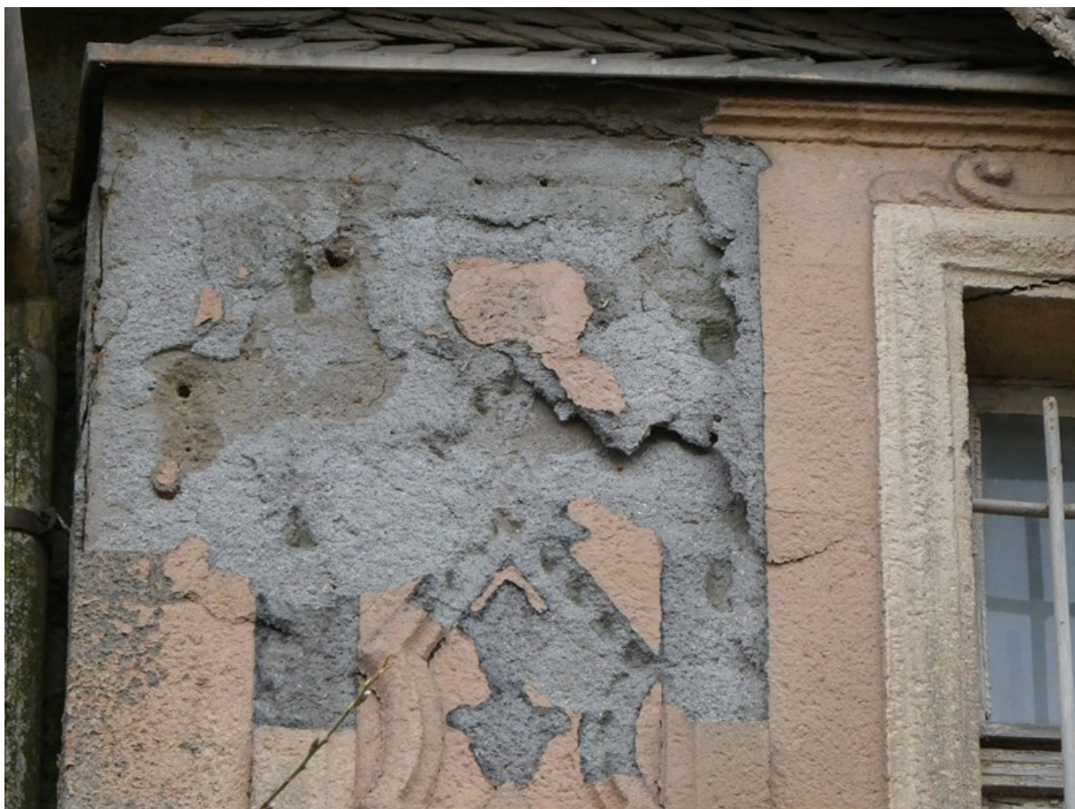
Foto 26: Fassade Hauptgebäude, Putzschollen als potenzielles Fledermaus-Quartier (exemplarisch), 02.12.2024.
