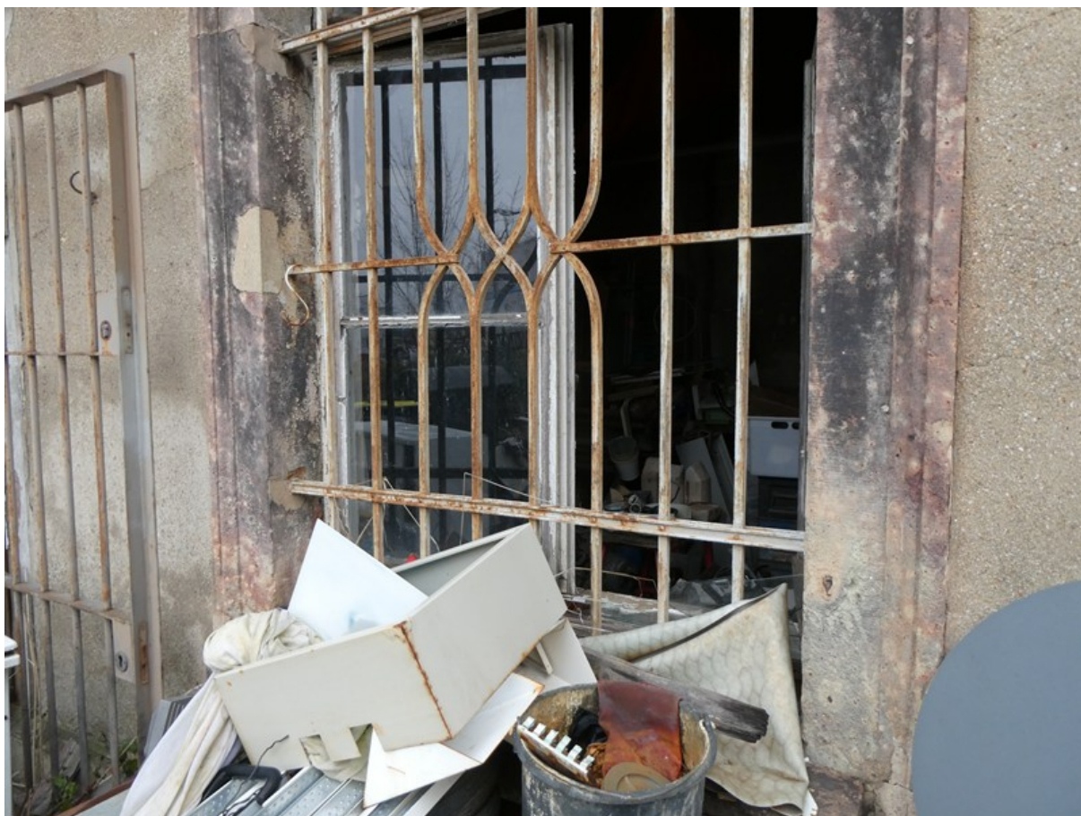
Foto 18: Anbau Hauptgebäude, stark vermüllte Innenräume, 02.12.2024.
